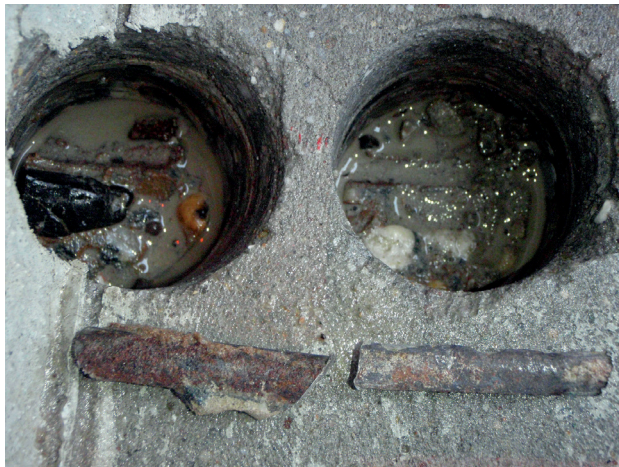
Figuur 3-5 Destructief onderzoek corrosie wapeningsstaal.
